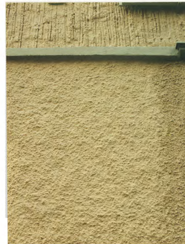
Putzwechsel vom Sockel- zum Obergeschoss
