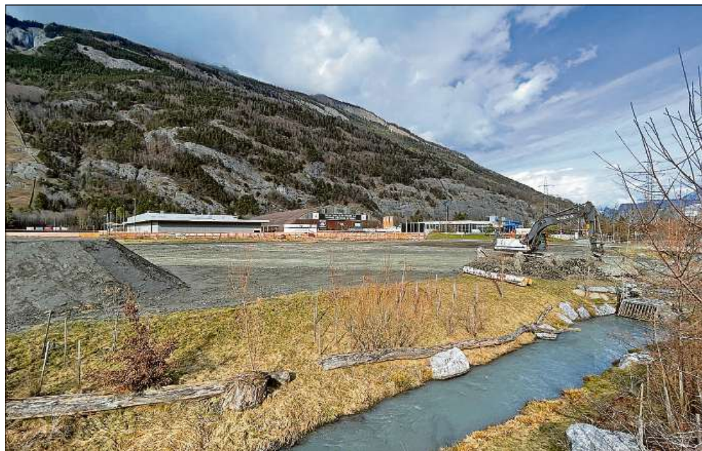
Bei der Realisierung des neuen Tribünengebäudes für den Rasensport auf der Oberen Au geht es zügig voran. Die Reithalle ist komplett verschwunden, das Gelände bereit für den Bau.
