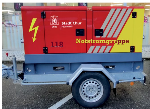
Autarkie im Depot Kalchbühl dank eines mobilen Notstromaggregats
